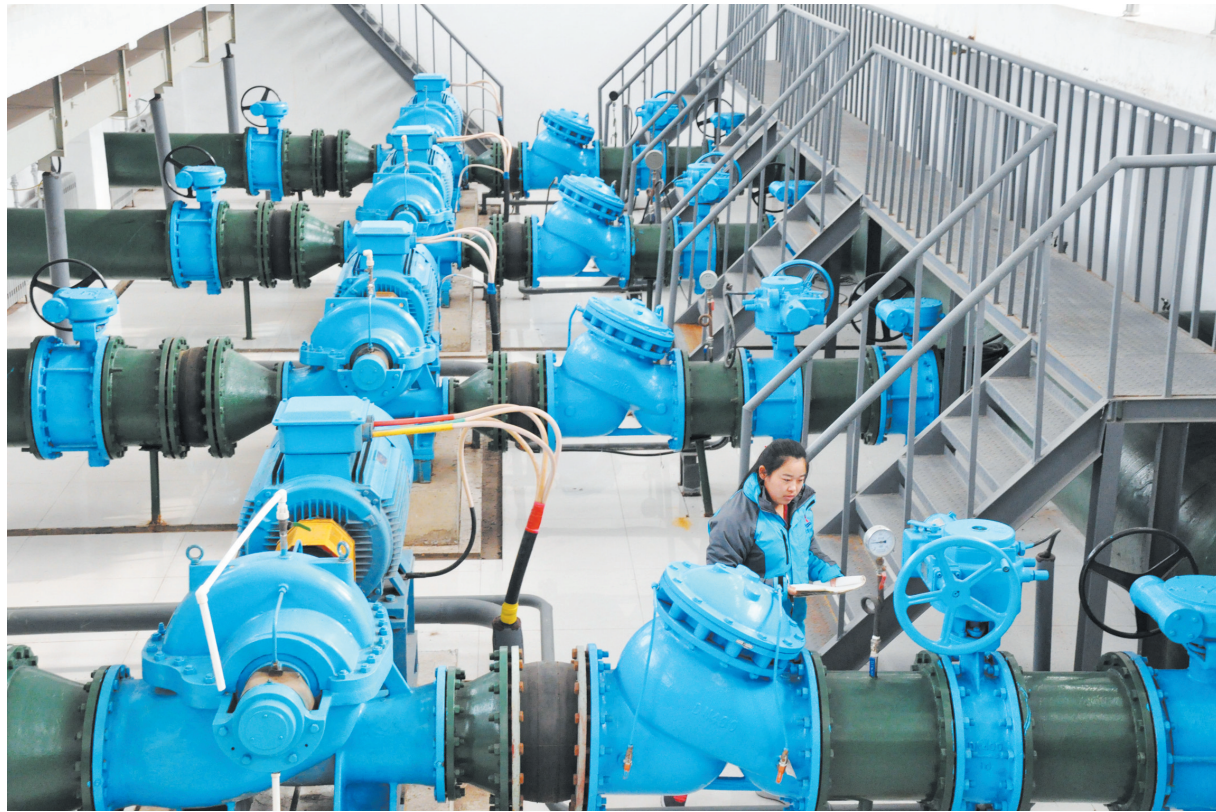
北海水务有限公司泵房24小时值班,确保全天候持续供水。
